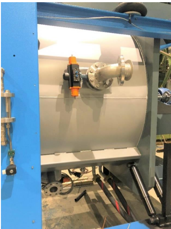
Außentrommel ohne Isolierung
